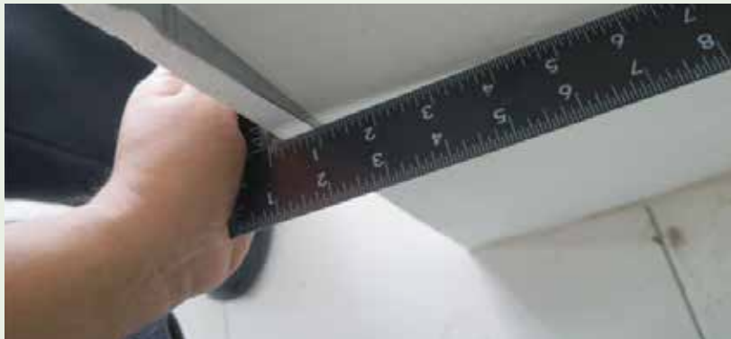
Permukaan dinding tidak rata
