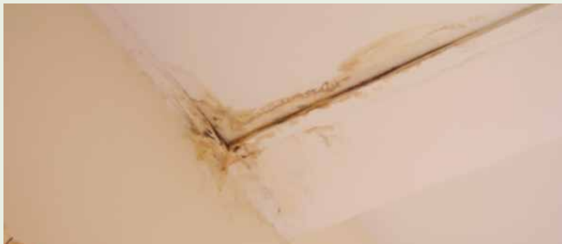
Kebocoran pada siling
