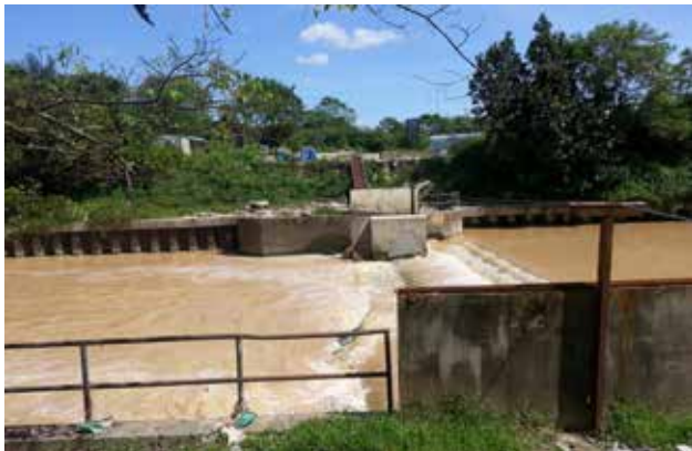
Lokasi Pemasangan Rubber Dam Muka Sauk Loji Rawatan Air Sungai Semenyih.
