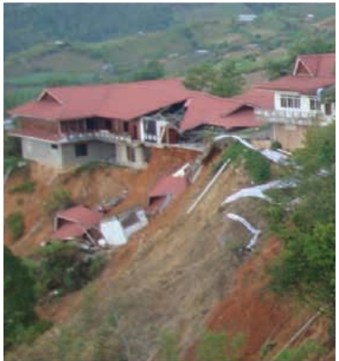
Runtuhan tanah di Kundasang, Sabah
