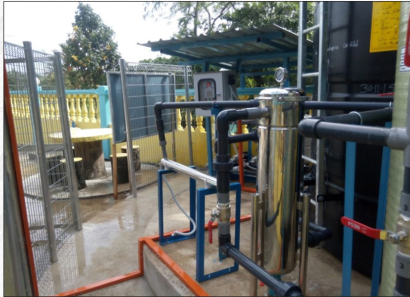
27.3 Sistem telaga tiub di Kampung Kuala Pajam, Beranang, Selangor.
