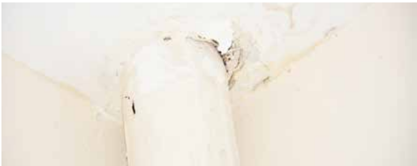
Kesan air dan pengelupasan lapisan cat akibat kebocoran pada siling
