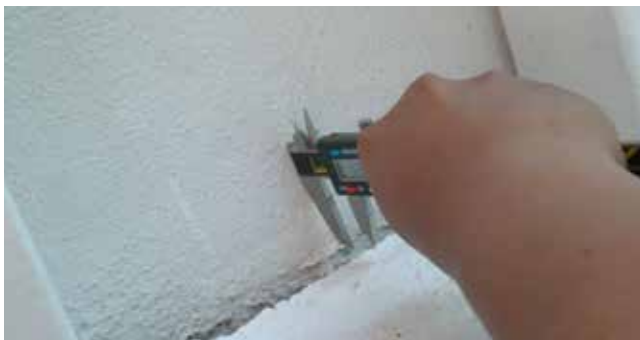
Pengujian keretakan pada sambungan antara binaan tembok pagar dan tiang
