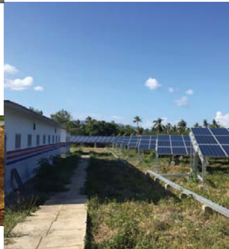
Projek Solar Hibrid di Pulau-pulau Semporna, Sabah
