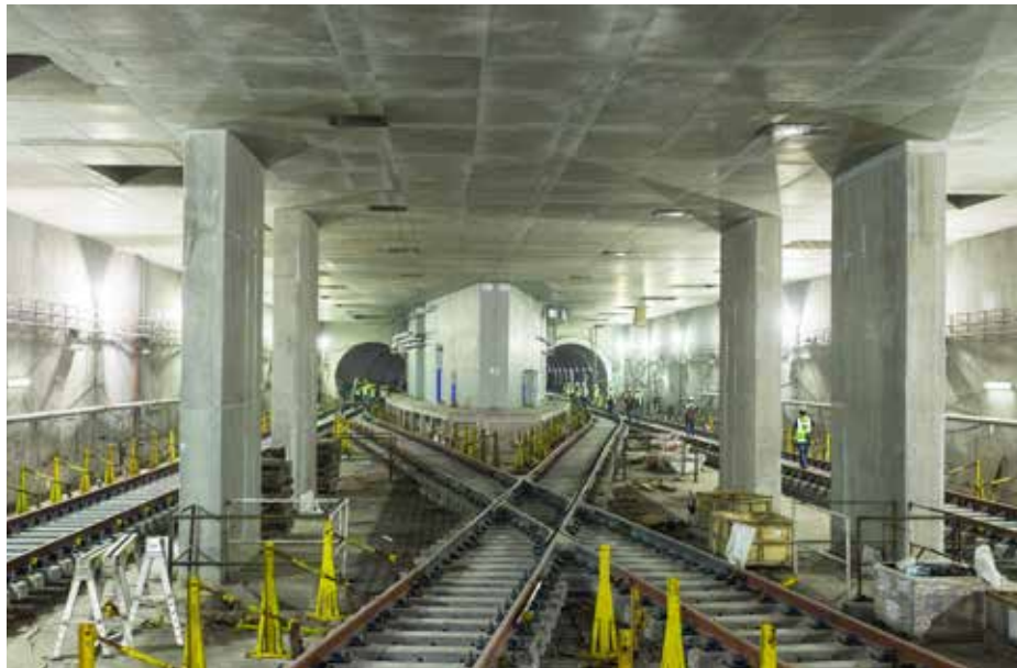
Tujuh stesen akan dibina di sepanjang 9.5km jajaran bawah tanah MRT Lembah Klang laluan Sungai Buloh - Kajang, bermula dari KL Sentral. Di atas adalah stesen MRT bawah tanah di Maluri. Gambar ihsan daripada Mass Rapid Transit Corporation Sdn Bhd
