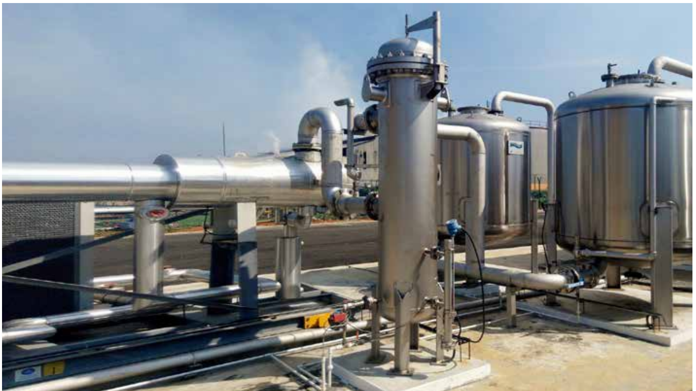
Loji biogas perintis milik Felda Global Ventures Holdings Berhad (FGV) yang mampu membekalkan gas termampat kepada entiti komersil telah memulakan operasinya di kilang Sungai Tengi, pada suku keempat tahun 2015. Kilang ini menjadi perintis bagi pemasangan kemudahan bioCNG skala komersil. BioCNG merupakan alternatif yang lebih berdaya maju dan menguntungkan berbanding menyalurkan tenaga elektrik yang diubah daripada metana ke grid nasional, yang terbukti mendatangkan cabaran kepada kilang-kilang yang terletak jauh dari stesen janakuasa
