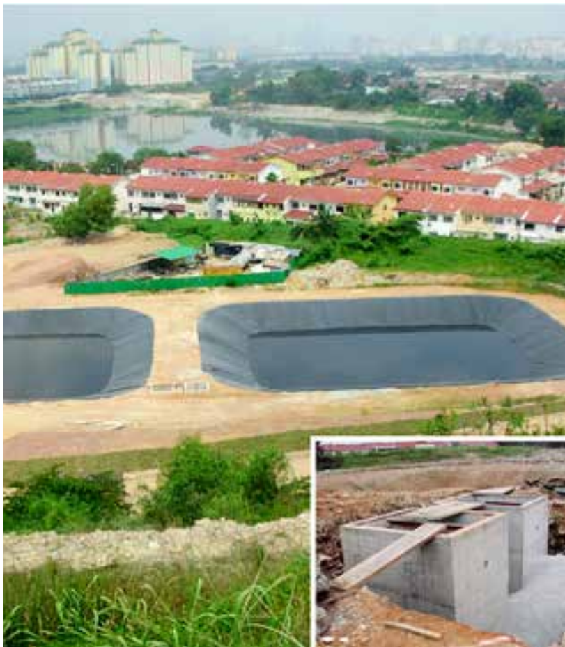
Kolam takungan Leachate , yang merupakan sebahagian daripada Loji Rawatan Leachate Taman Beringin. (Sisipan) Takung Leachate
