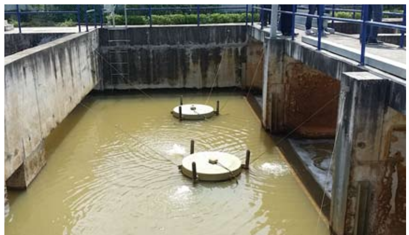
Loji Rawatan Air Sungai untuk Sg Sering
