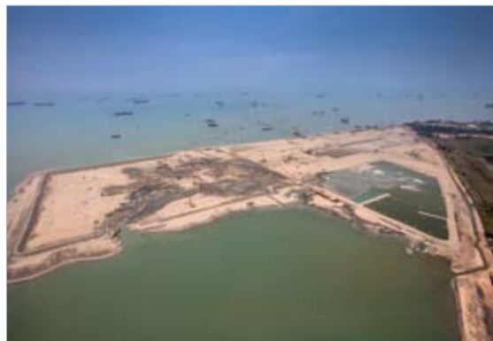
Terminal penyimpanan bebas Pengerang - status tebus guna tanah
